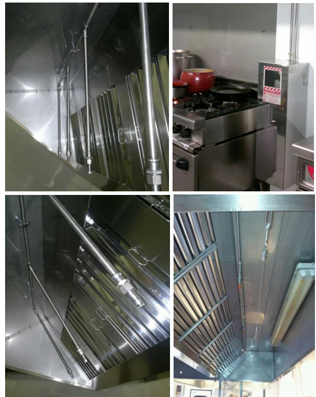
Fotos: Armario y líneas del sistema CROCADE.
